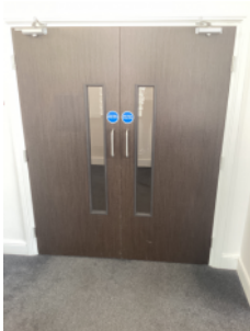
Corridor fire door
