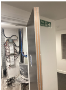
CCTV/ riser cupboard door
