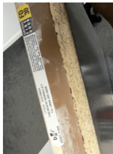
CCTV cupboard door
